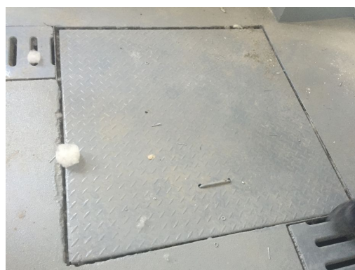
渗滤液收集沟及收集池
