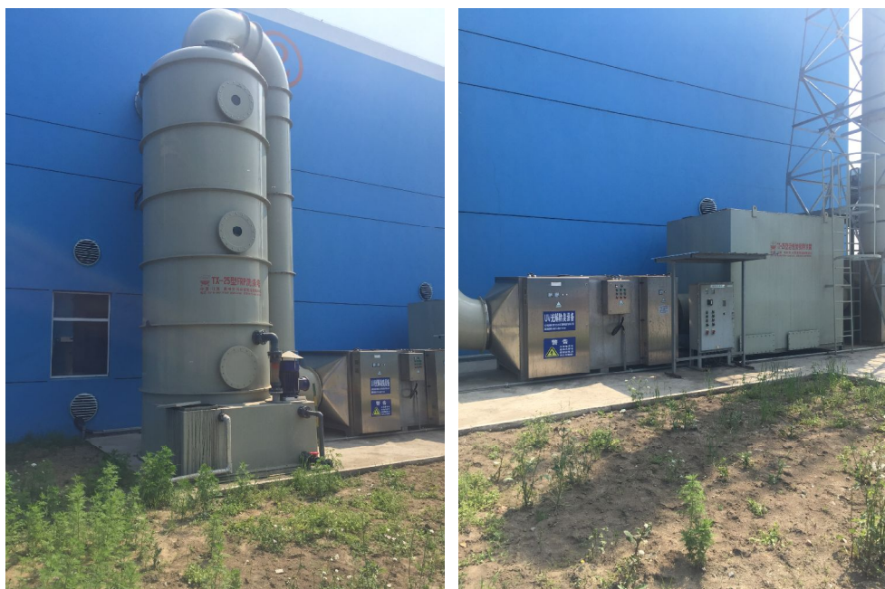
仓库废气处理设施
