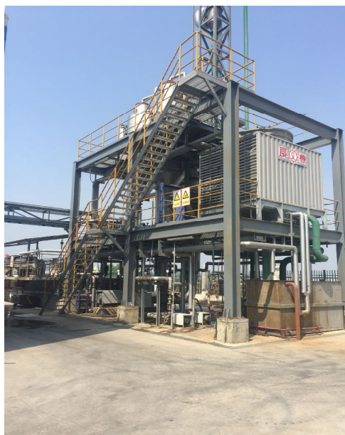
二效蒸发装置
