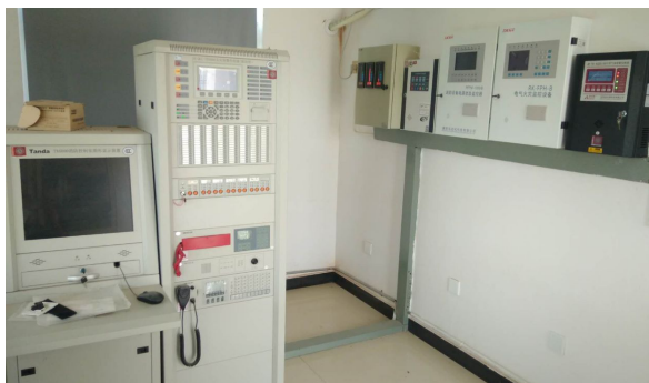
火灾报警系统控制室
