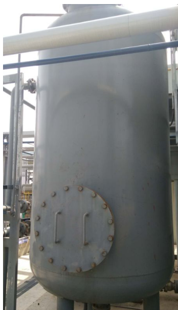
石英砂过滤罐
